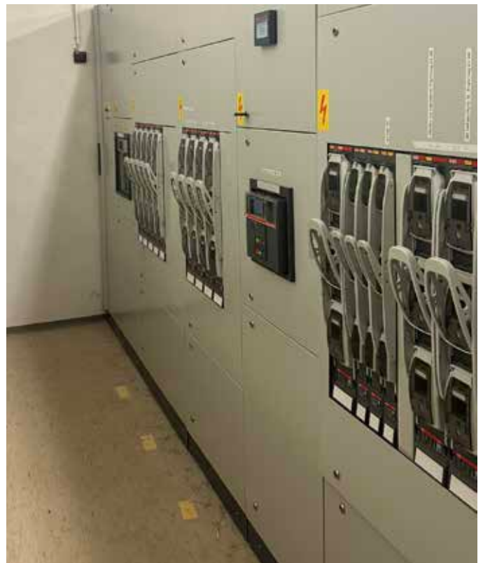
Teile der Niederspannungshauptverteiler
